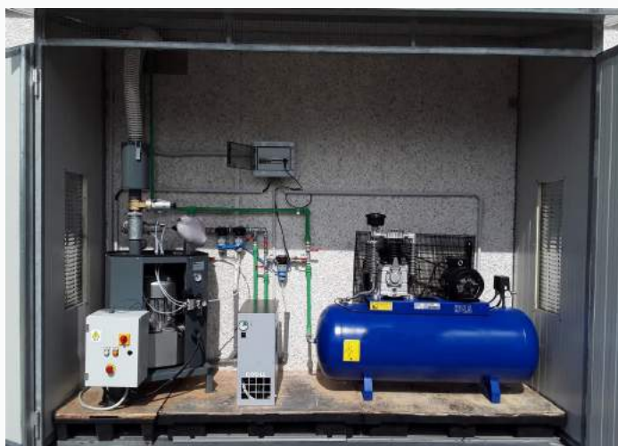
Soufflante à canale latérale dans le local technique Separated side channel blower unit in technical environment
